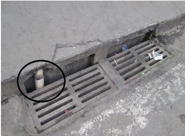
Figura 65: Ligação clandestina - Av. Berenice Magalhães Pinto Fonte: Projeta Engenharia (2015)
