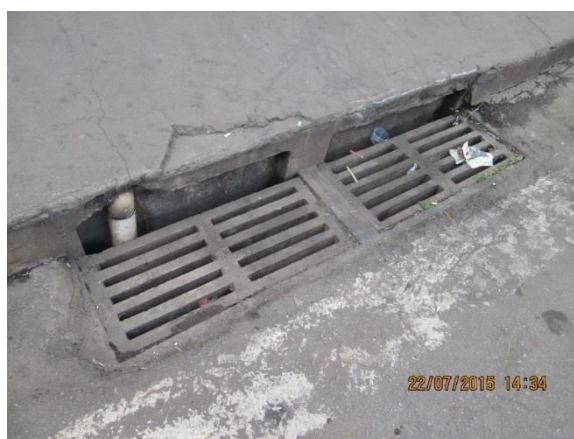
Figura 51 – Ligação clandestina em Rede pluvial, Centro
