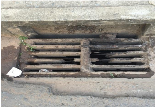
Figura 62: Boca de lobo deteriorada
