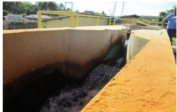
Figura 22 – Calha Parshall Fonte: Projeta Engenharia (2015)
