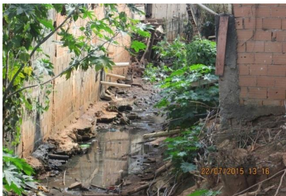
Figura 49 – Lançamento individual direto no manancial, bairro Vila Madalena
