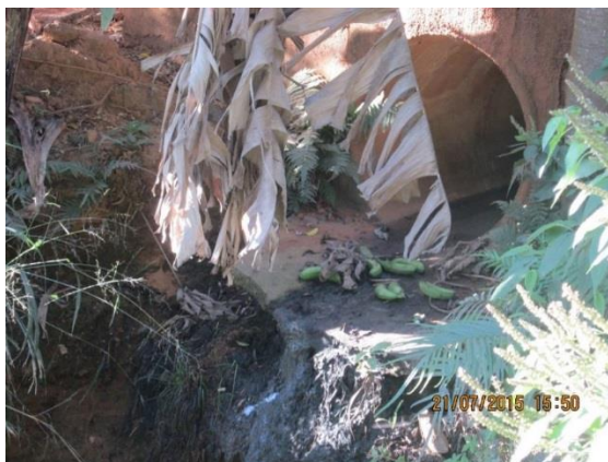
Figura 33 - Lançamento de esgoto - Bairro Progresso
