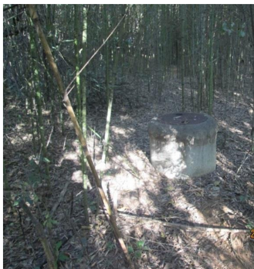
Figura 34 - Poço de visita do interceptor da rede coletora do Bairro Progresso
