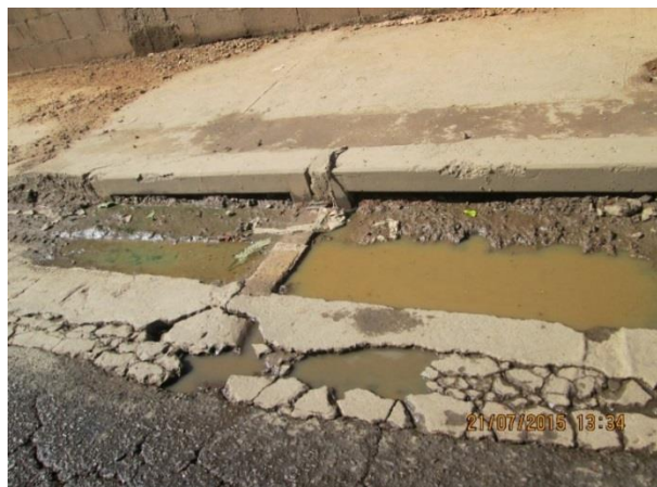
Figura 64: Boca de lobo obstruída, impedindo o escoamento de água
