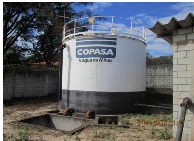
Figura 32 – Reservatório de 100 m 3 Vivenda Santa Mônica
