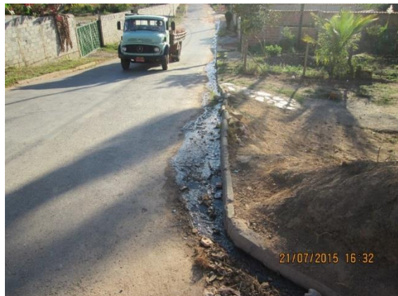
Figura 47 – Esgoto doméstico lançado a céu aberto, Bairro Aparecida Fonte: Projeta Engenharia (2015)
