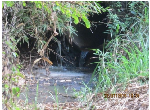
Figura 39 – Lançamento in natura em manancial proveniente do interceptor localizado na Avenida Sete de Setembro
