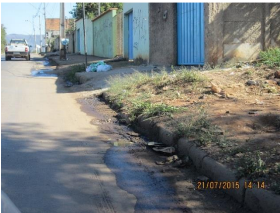
Figura 46 – Esgoto doméstico lançado a céu aberto, Bairro Fernão Dias Fonte: Projeta Engenharia (2015)
