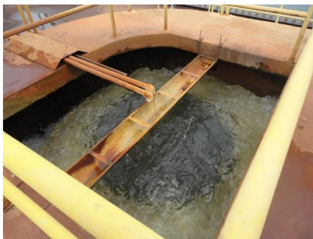
Figura 8 – Entrada de água bruta Fonte: Projeta Engenharia (2015)
