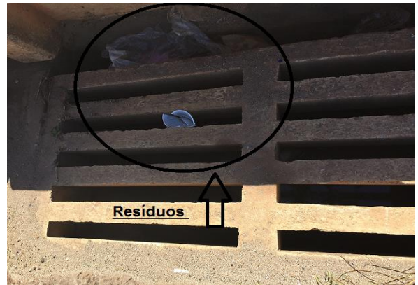
Figura 63: Boca de lobo com resíduos
