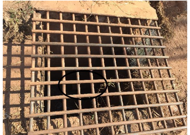
Figura 66: Ligação clandestina Fonte: Projeta Engenharia (2015)
