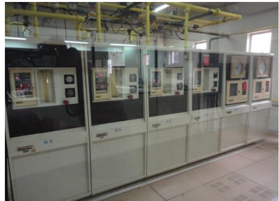
Figura 17 - Aquecimento de cloro e dosagem (Local onde o cloro é transformado do estado líquido para gasoso)
