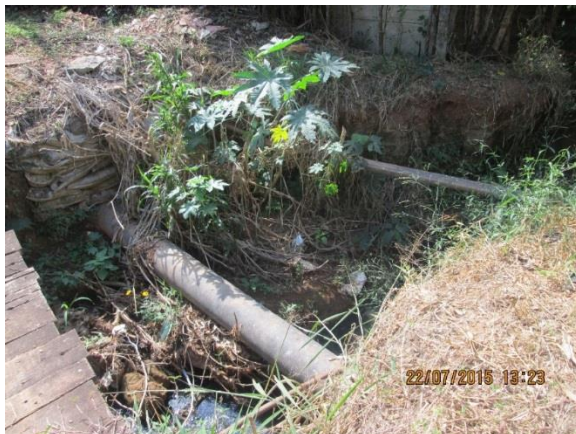
Figura 38 – Interceptor localizado na Avenida Sete de Setembro Fonte: Projeta Engenharia (2015)
