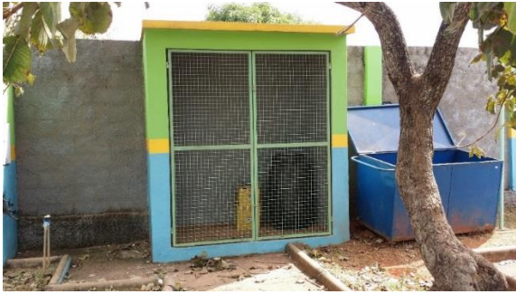
Figura 92 – Abrigo utilizado para armazenamento das bombonas contendo RSS da UBS Amaro Luiz Campos Fonte: Projeta Engenharia (2015)
