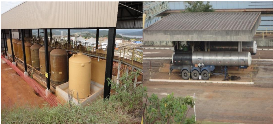
Figura 19– Armazenamento de produtos Químicos
