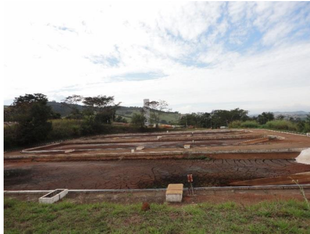
Figura 15- Leitões de secagem de lodo
