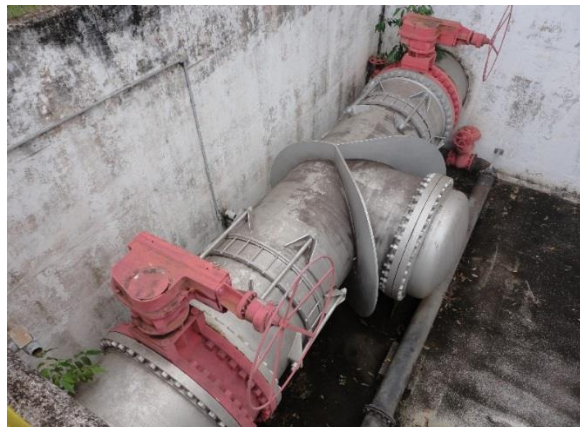
Figura 7 – Adutora de água bruta (trecho com recalque) Fonte: Projeta Engenharia (2015)
