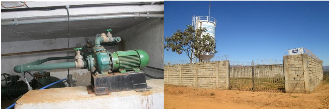
Figura 30 – Booster e Reservatório elevado - Pousada Del Rey
