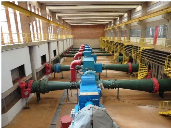
Figura 6 – Estação elevatória de água Fonte: Projeta Engenharia (2015)
